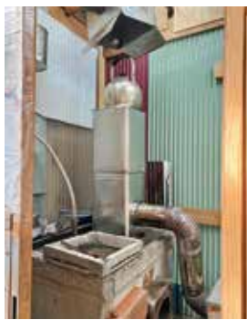
廃材のみ利用したDIY暖炉。
